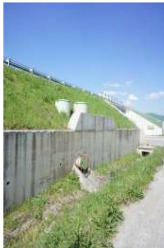
Slika 3 Ispust za pročišćene otpadne i oborinske vode
